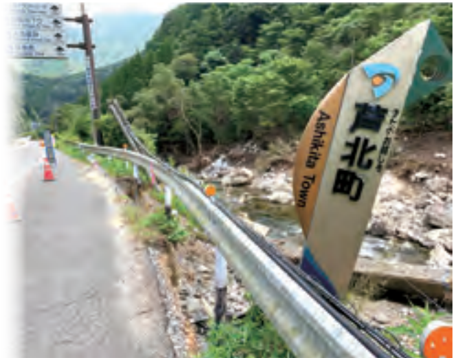
球磨川氾濫によって傾いた看板
